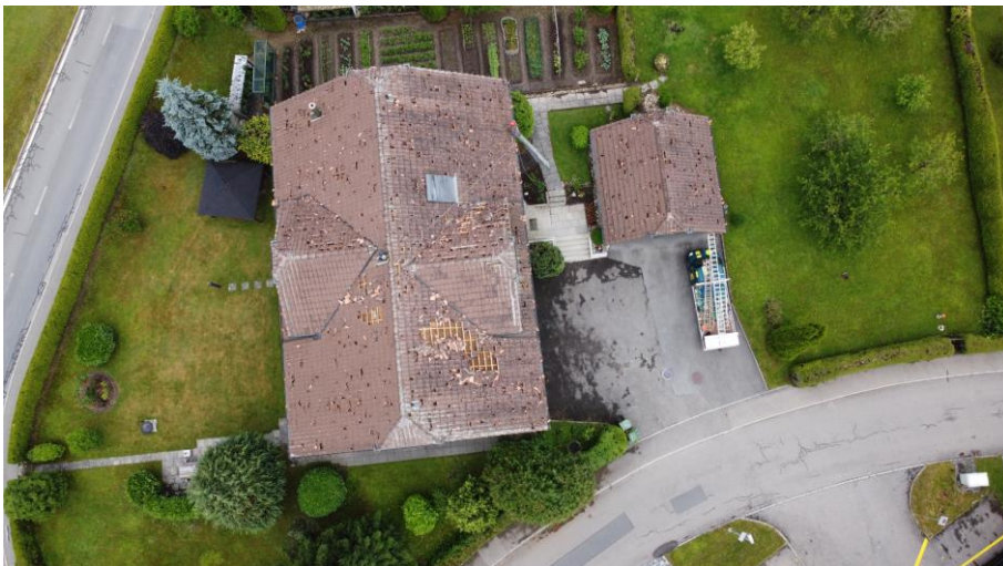
Bild 2: Im Kanton Luzern wurden zahlreiche Dächer stark beschädigt. (zvG Gebäudeversicherung Luzern)
