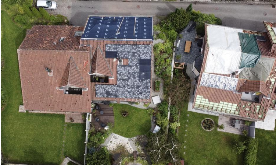
Bild 1: Im Kanton Luzern wurden zahlreiche Dächer und Photovoltaikanlagen stark beschädigt. Notdächer, wie beim Gebäude auf der rechten Seite, waren notwendig, um weitere Schäden zu verhindern (zvG Gebäudeversicherung Luzern)
