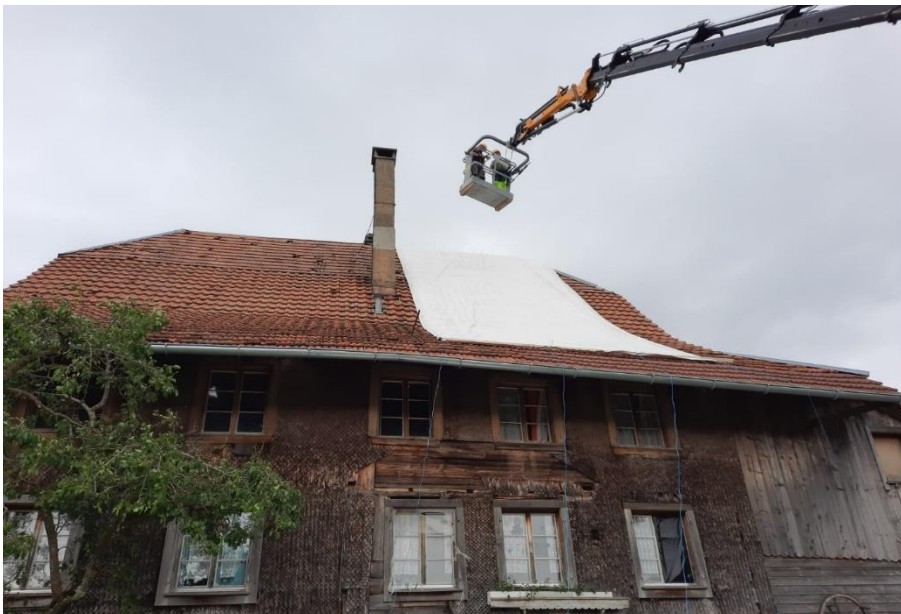
Bild 1: Holzfeuerungen können für provisorisch abgedeckte Dächer eine Brandgefahr sein (zvg Gebäudeversicherung Luzern)
