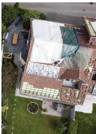
Bild 2: Holzfeuerungen können für provisorisch abgedeckte Dächer eine Brandgefahr sein. (zvg Gebäudeversicherung Luzern)
